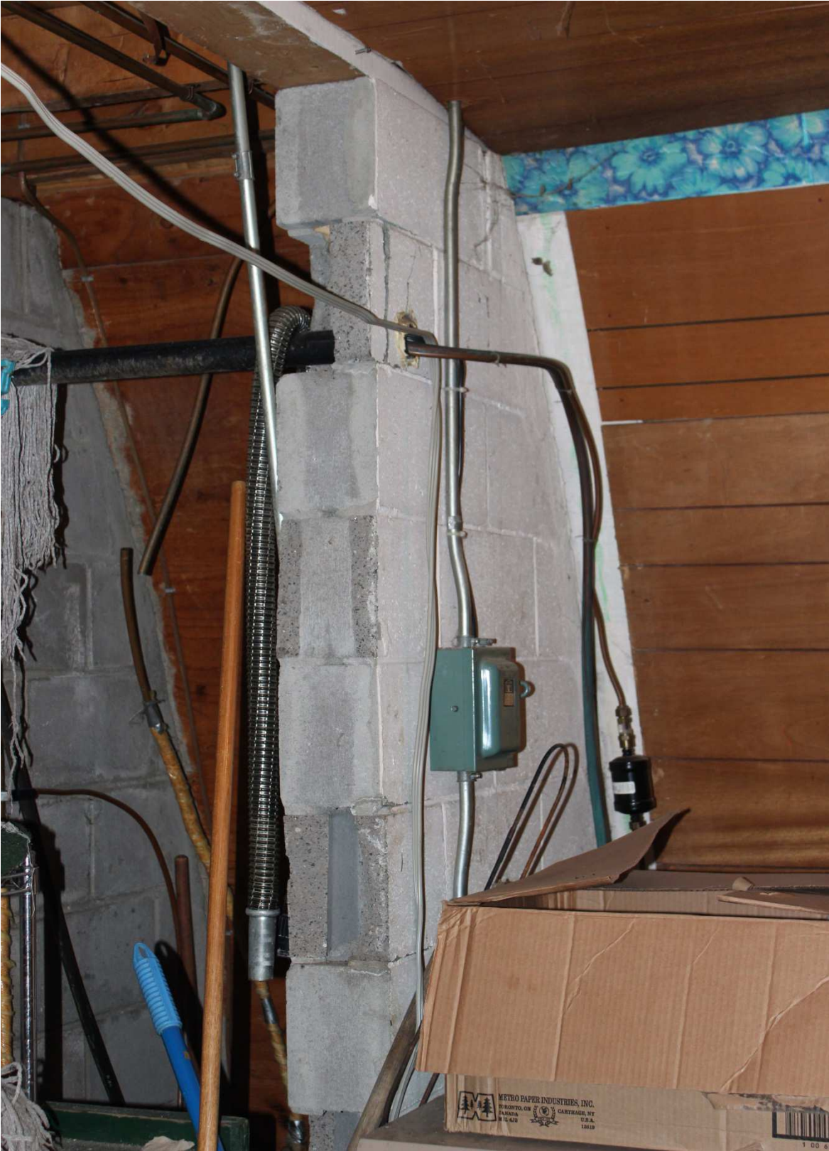
Le bois de charpente, apparent sur le mur arrière, abrite un panneau électrique et ne permet pas d'offrir une résistance au feu de 45 minutes.
