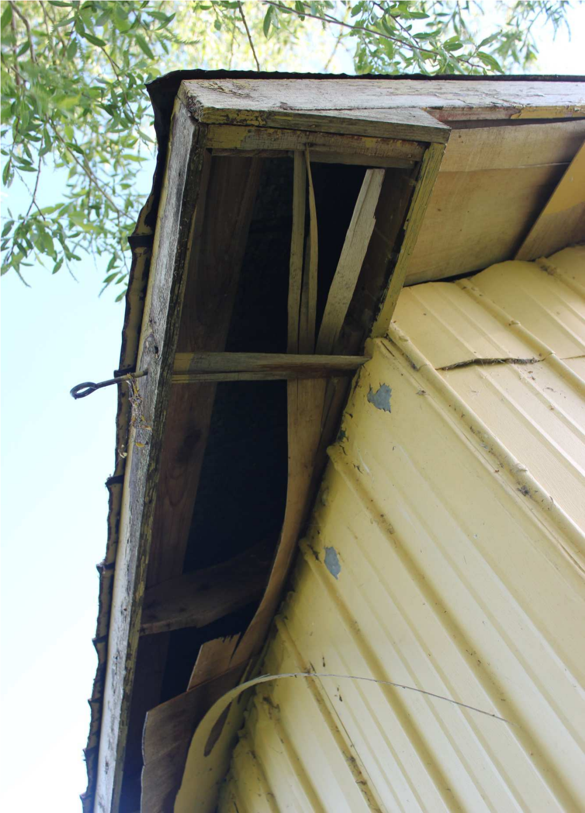
L'état lamentable des soffites en bois aux corniches
