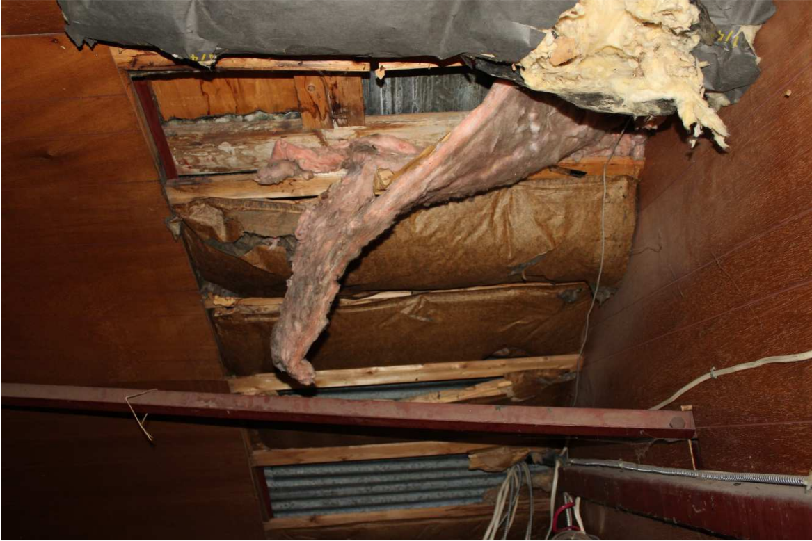
L'isolant en laine, humide et moisi, s'effrite et s'affaisse dans l'entretoit.
