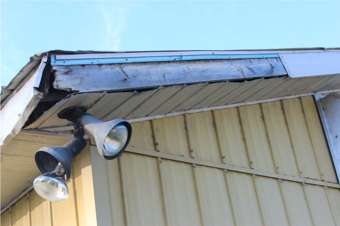
Le revêtement métallique des fascias et le bois qu'il recouvre sont en très mauvais état par endroits.
